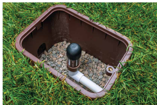
Zamontowany zawór odpowietrzający/próżniowy
