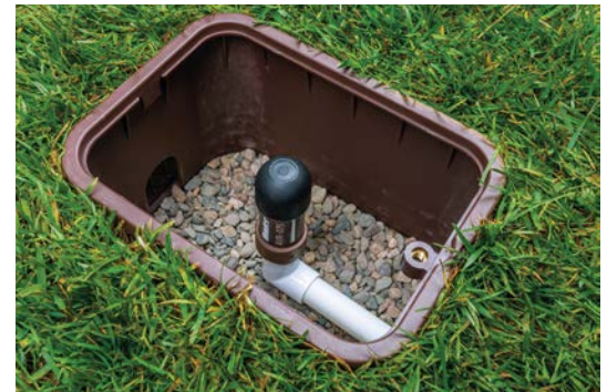
Válvula de Alívio de Vácuo/ar Instalada
