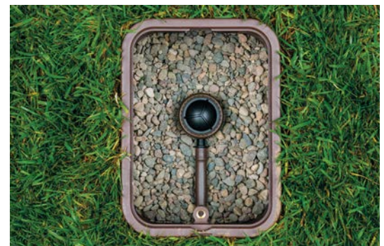
Válvula de Descarga Automática Instalada
